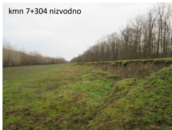
Fotografija 2-1: Odroni na desnom nasipu OK Lonja-Strug od kmn 7+000 do kmn 8+000
