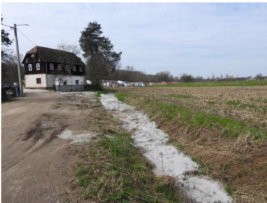
Fotografija C-59: Kanal zatrpan betonom na užem području planirane prometnice, oko stacionaže 4+800 Izvor: Terenski obilazak
