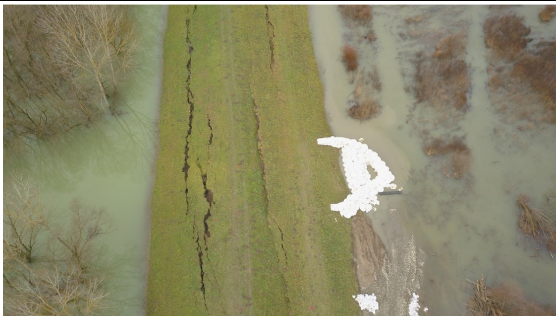
Snimak dronom oštećenja nasipa na lokaciji Galdovo 07.01.2021.
