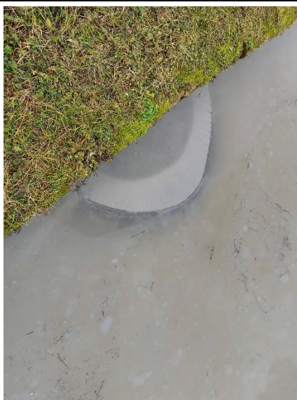
Zaobalna strana nasipa: ispiranje pijeska iz temeljnog tla na lokaciji čepa.
