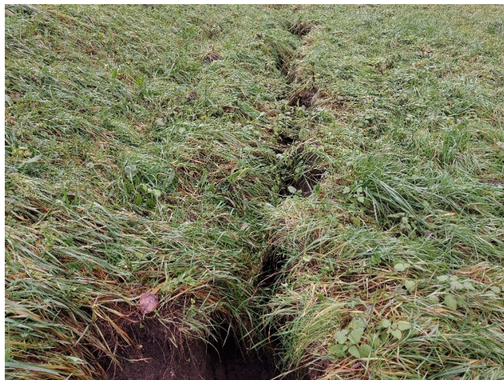
Vodna strana nasipa: pukotina na spoju berme i tijela nasipa. Širina pukotine je 5 cm.
