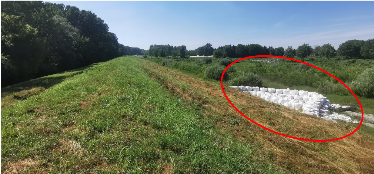
Negativni zdenac na zaobalnoj strani propusta s čepom izveden od box barijera
