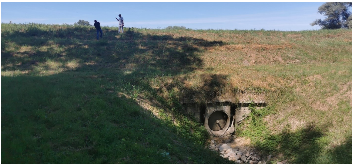
Propust s čepom izvan funkcije
