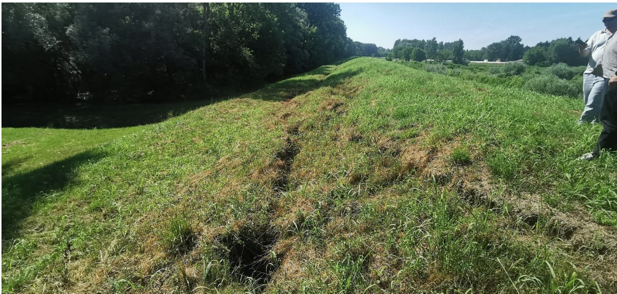
Vertikalne pukotine u vodnoj bemi dubine preko 3 m i širine do 50 cm
