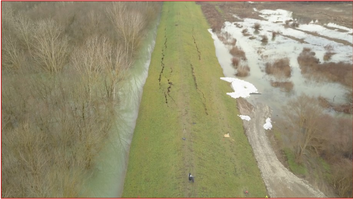
Snimka dronom oštećenja nasipa i propusta s čepom od 07.01.2021.
