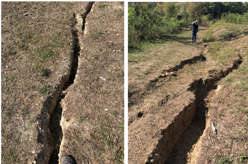
Fotografija 2.3-4 Skup pukotina 1
