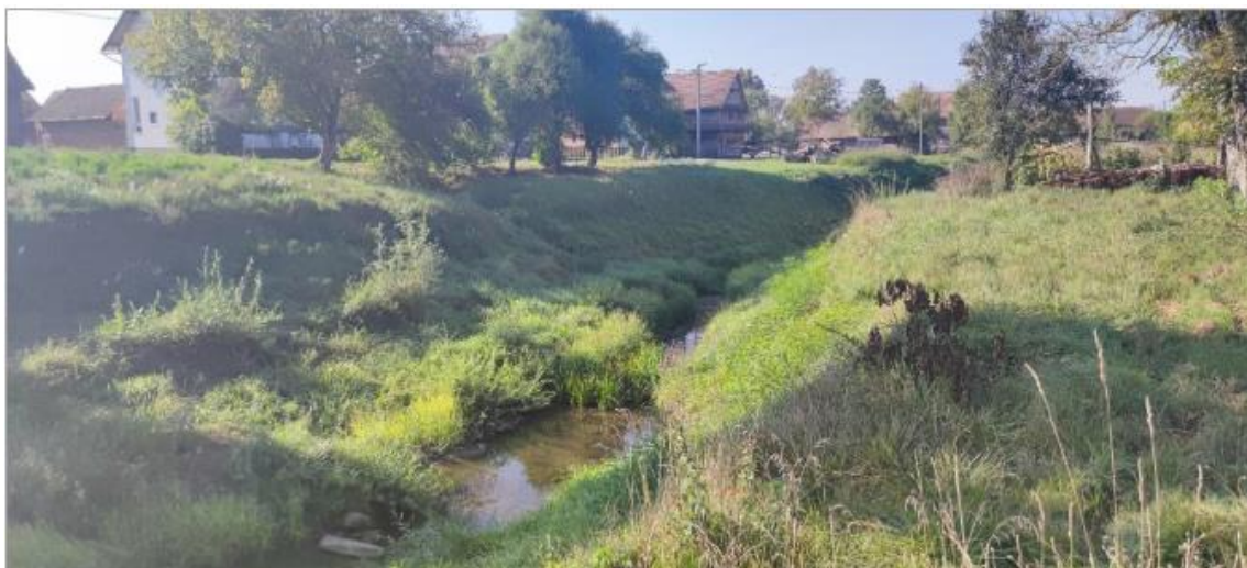
Slika 2.2-3 Korito vodotoka Subocka na početnoj stacionaži projektiranog kanala (Izvor: Idejno rješenje, studeni 2022)
