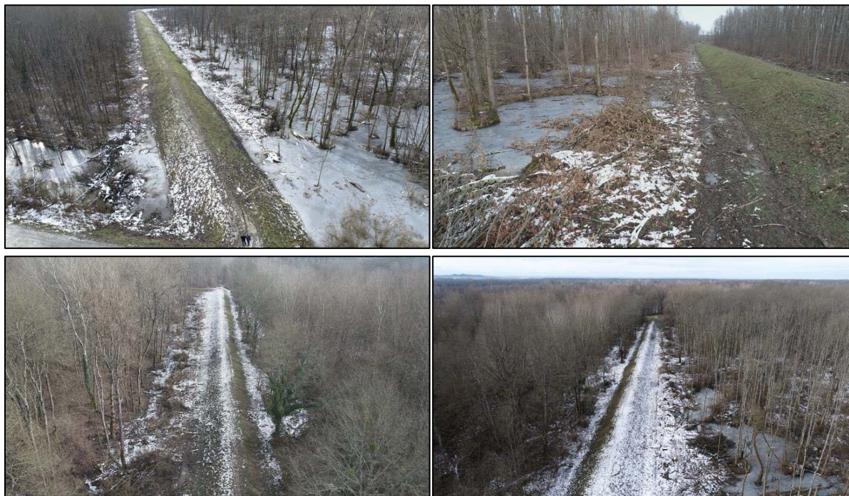
Slika 6. Postojeće stanje južnog nasipa retencije Mlaka, slika 2 (Glavni projekt, Geokon-Zagreb d.d., svibanj 2021.)
