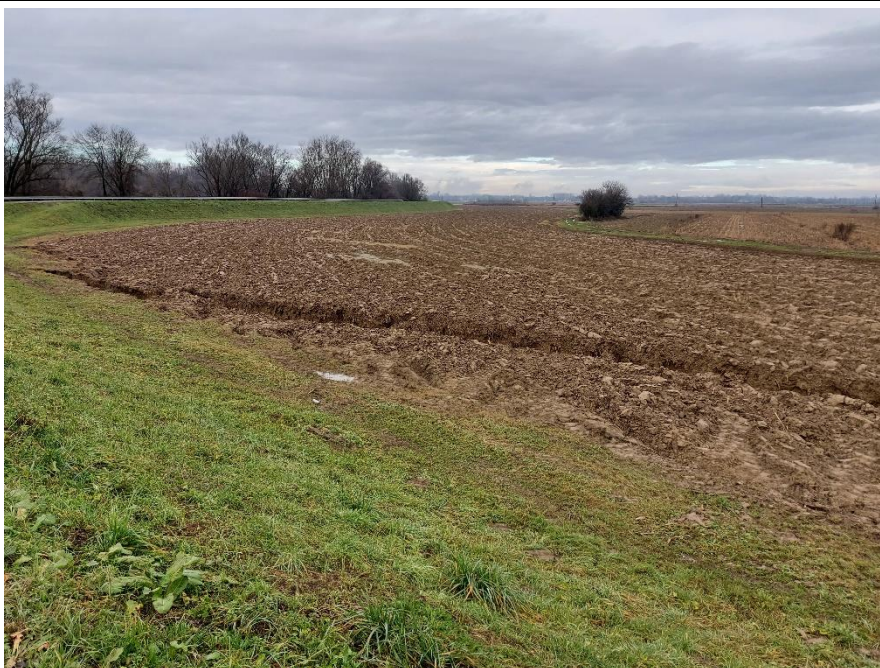
Pukotina u zaobalju, neposredno uz nasip
