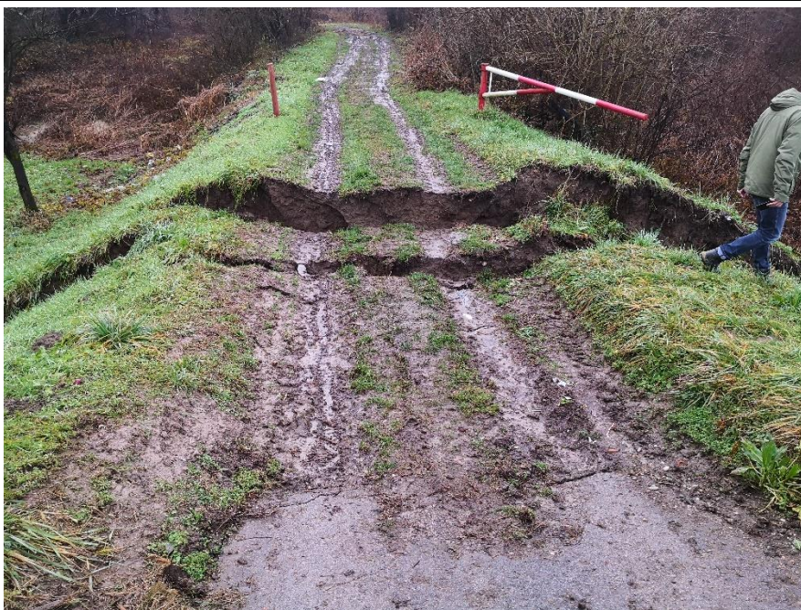
Oštećenja nasipa na kontaktu s rampom na vodnoj strani
