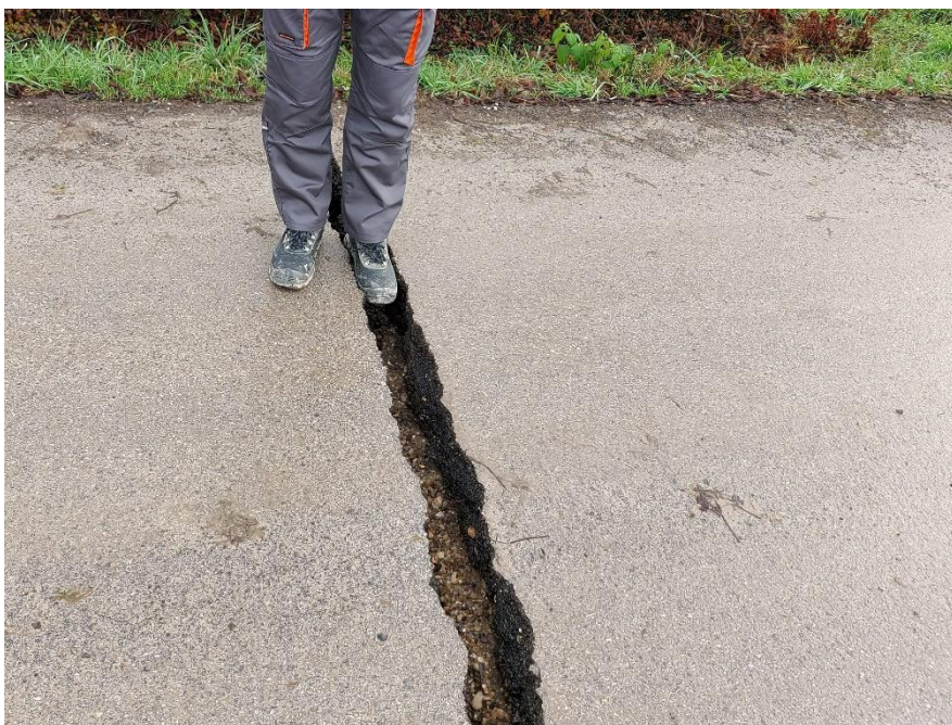
Oštećenja nasipa – slijeganje krune nasipa i pucanje kolničkog zastora
