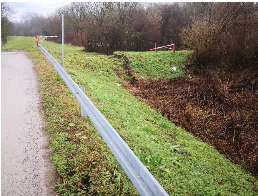
Pukotina na kontaktu vodozaštitnog nasipa i nasipa rampe za prilaz inundaciji
