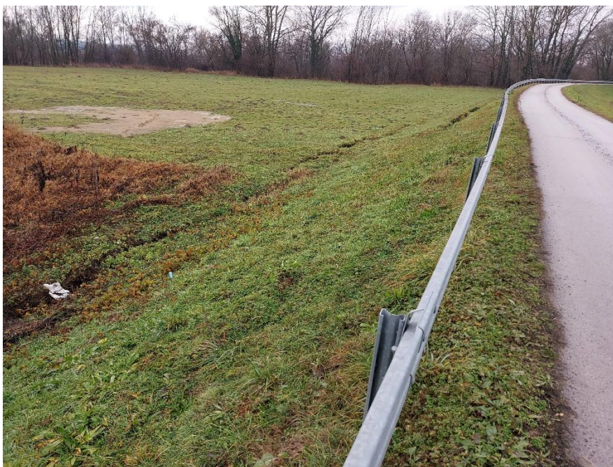
Pukotina u vodnoj nožici nasipa (pružanje pukotine paralelno s osi nasipa) te pukotina u inundaciji i iznešeni pijesak
