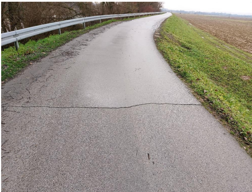
Oštećenja na vodozaštitnom nasipu u Palanjk (stanje od 30.12.2020.)
