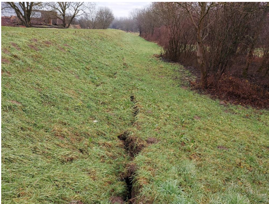
Oštećenja na vodozaštitnom nasipu u Palanjkju (stanje od 30.12.2020.)
