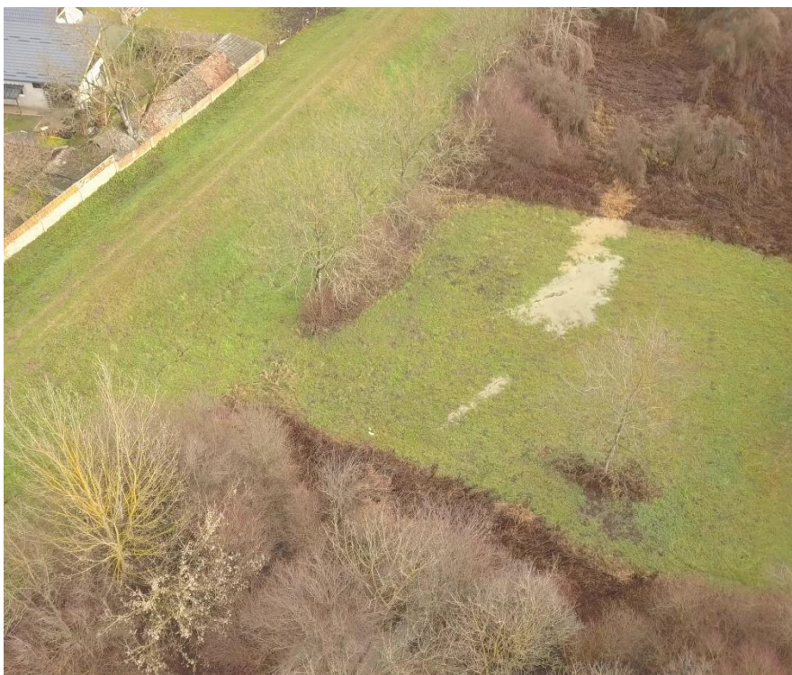
Pukotina u vodnoj nožici nasipa (pružanje pukotine paralelno s osi nasipa)
