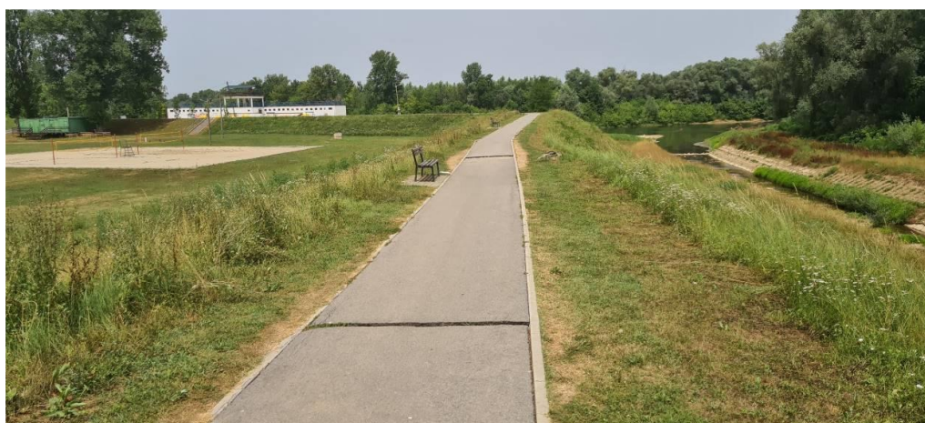
Zona oštećenja, pukotine u asfaltu šetnice
