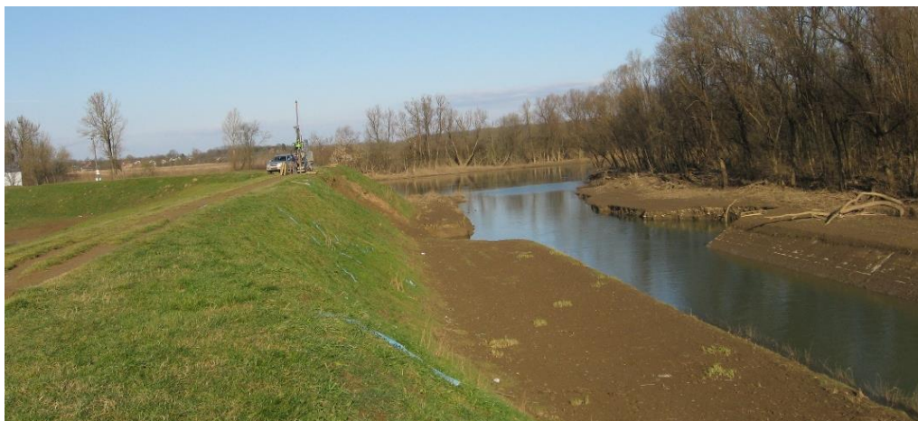
Pogled na nasip prema ušću Petrinjčice u rijeku Kupu. Oštećenje korita i pokosa nasipa
