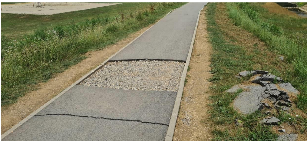
Zona oštećenja, pukotine u asfaltu šetnice
