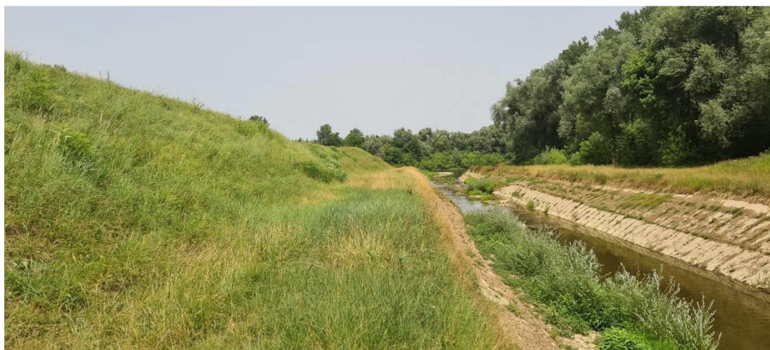
Inundacijski prostor u zoni oštećenja nasipa
