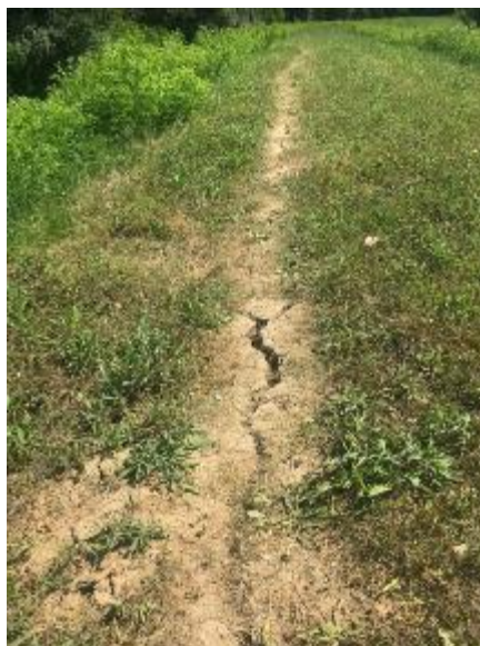
Slika 8. Uzdužna pukotina na kruni nasipa - Dionica 6
