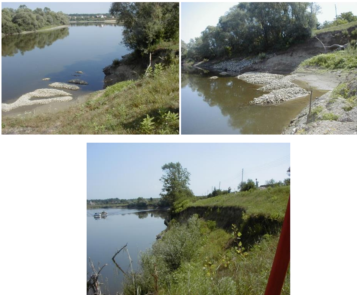
Fotografija 2-1: Oštećenja obale i nasipa kod naselja Mlaka (a-c)
